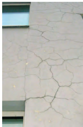
Рис. 16а. Трещины на штукатурке, затворенной избытком воды
