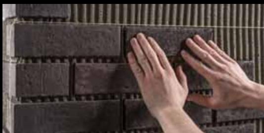
Укладка плоских клинкерных плиток с помощью шнура. Клинкерные плитки вдавливаются в слой клея.
