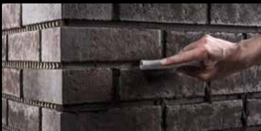
При расшивке швов кельмой можно выработать различные оптические элементы. Будь-то заглубленная затирка или шов, выполненный кельмой, который, как в данном случае, легко вжимается или вытягивается с помощью шланга.
